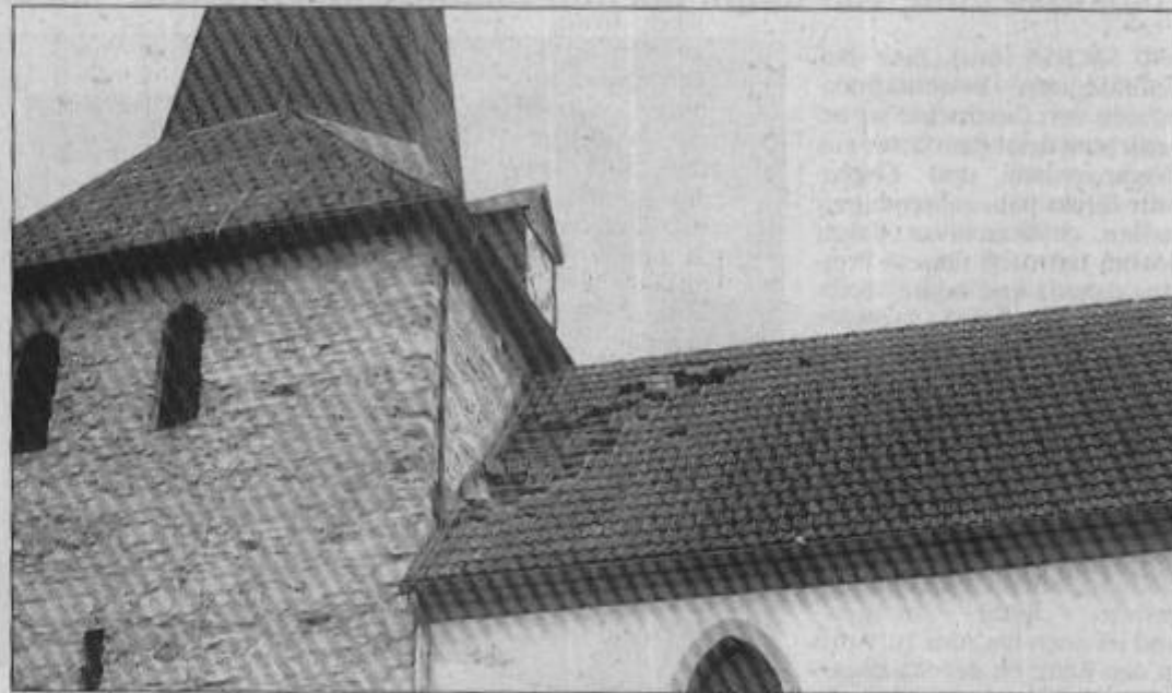
Im Dach der Bartolfelder St. Bartholdi-Kirche klafft ein etwa zehn Quadratmeter großes Loch – die Unterkonstruktion verhinderte, dass Regen eindrang und größeren Schaden anrichtete. Foto: dah
